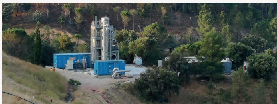
Evapo Concentrateur et chaudière à biogaz
