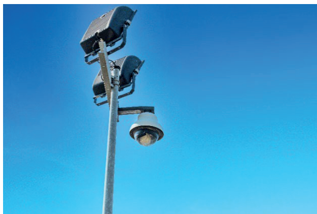
3 mats pour l'éclairage et la vidéo afin de télésurveiller l'ouvrage en tout temps
