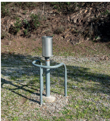
1 pluviomètre pour avoir une mesure pluviométrique locale
